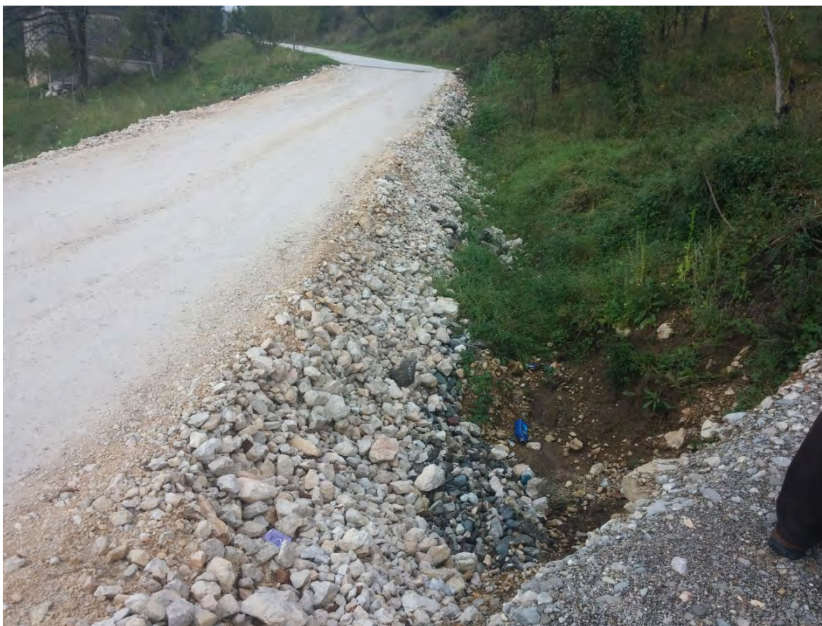
Slika broj: 6. Privremeno sanirano klizište
