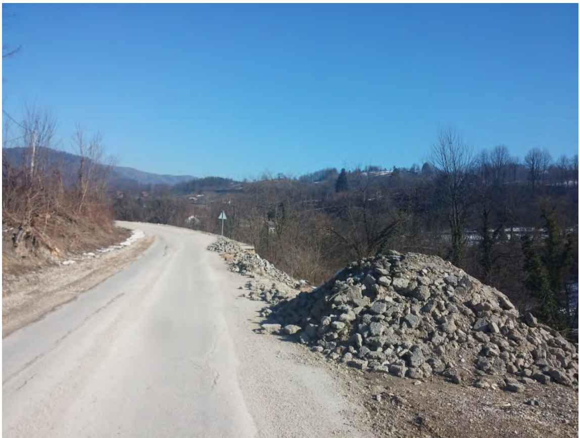
Slika broj: 41. Privremena uspostava prohodnosti u zoni klizišta
