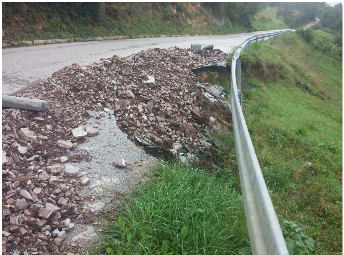
Slika broj:3. Klizište prije škole u Pojskama
