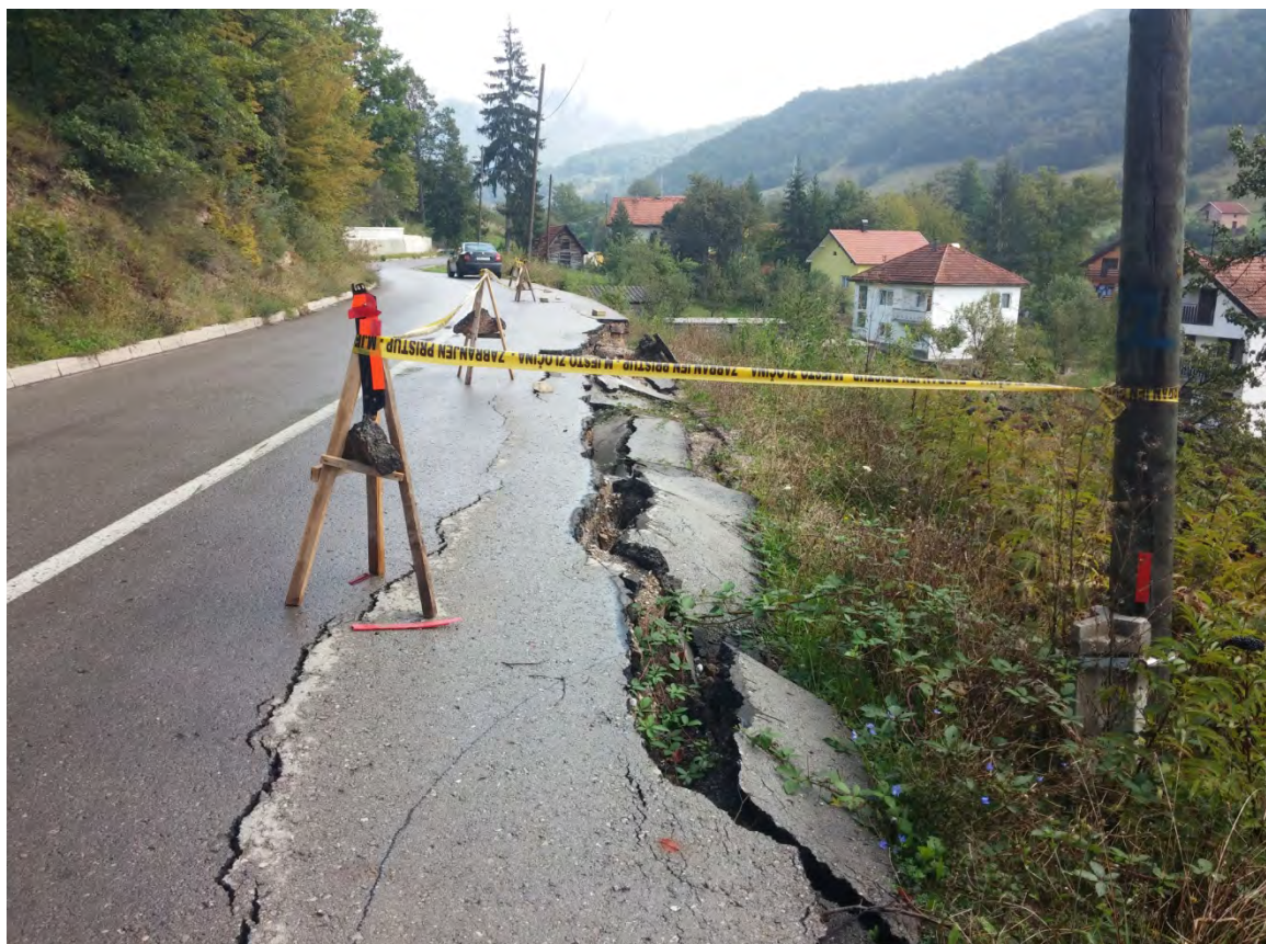
Slika broj: 48. Klizište Haljinići
