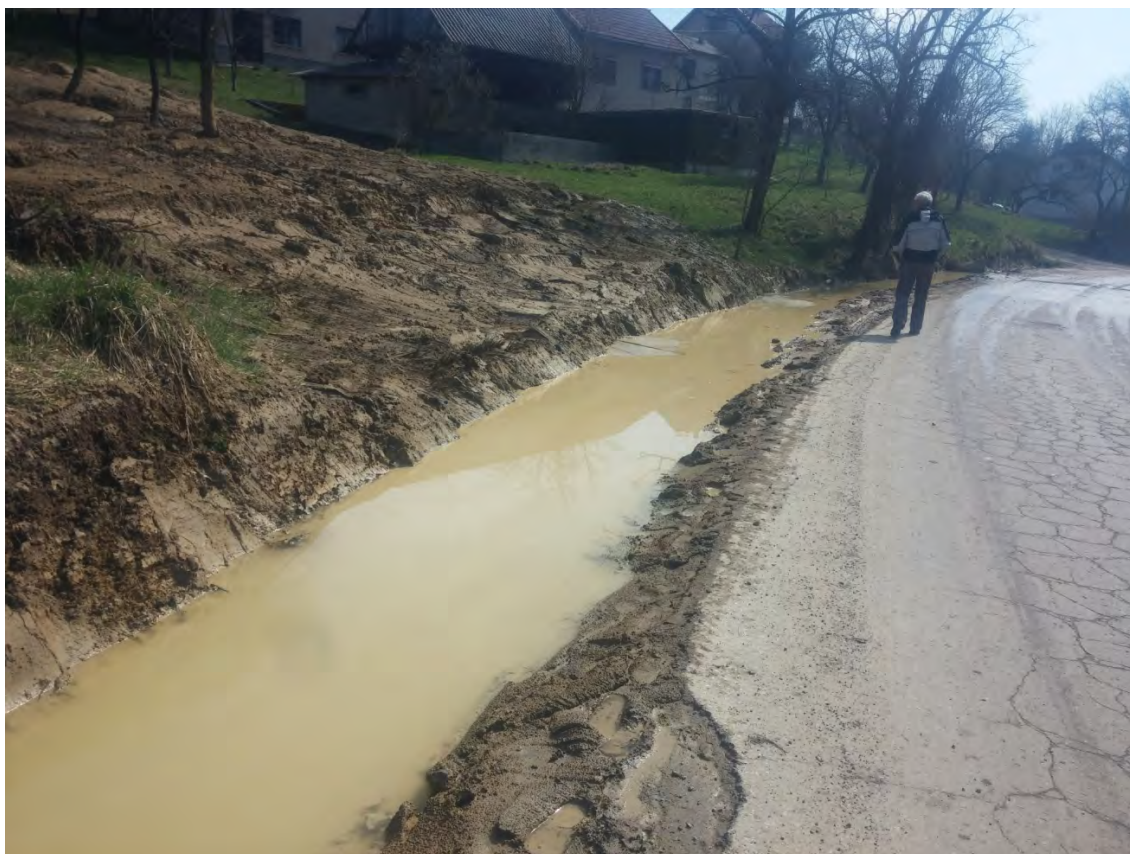
Slika broj: 4. Ugrožen cestovni kanal od aktivnog klizišta
