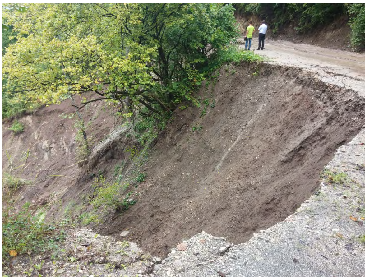
Slika broj: 45. Klizište na cesti u blizini Lipnice
