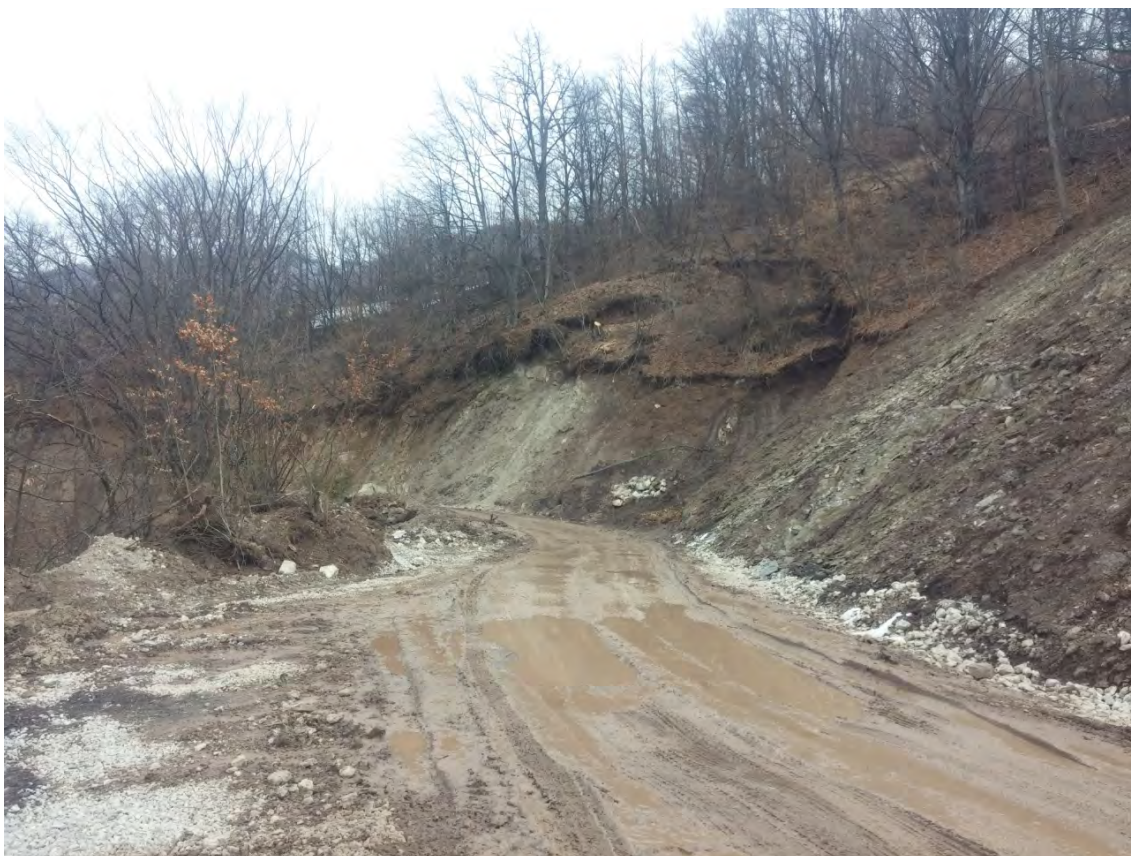
Slika broj: 46. Privremeno usječena saobraćajnica na klizištu
