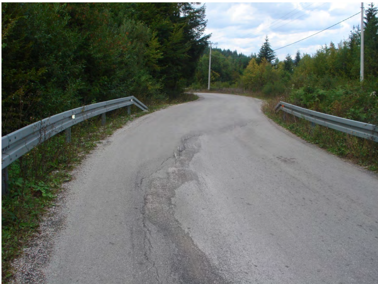
Slika broj: 62. Klizište na reg. cesti Olovo - Sokolac
