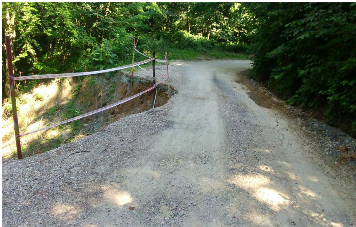
Slika broj:68. Klizište na makadamskoj dionici ceste
