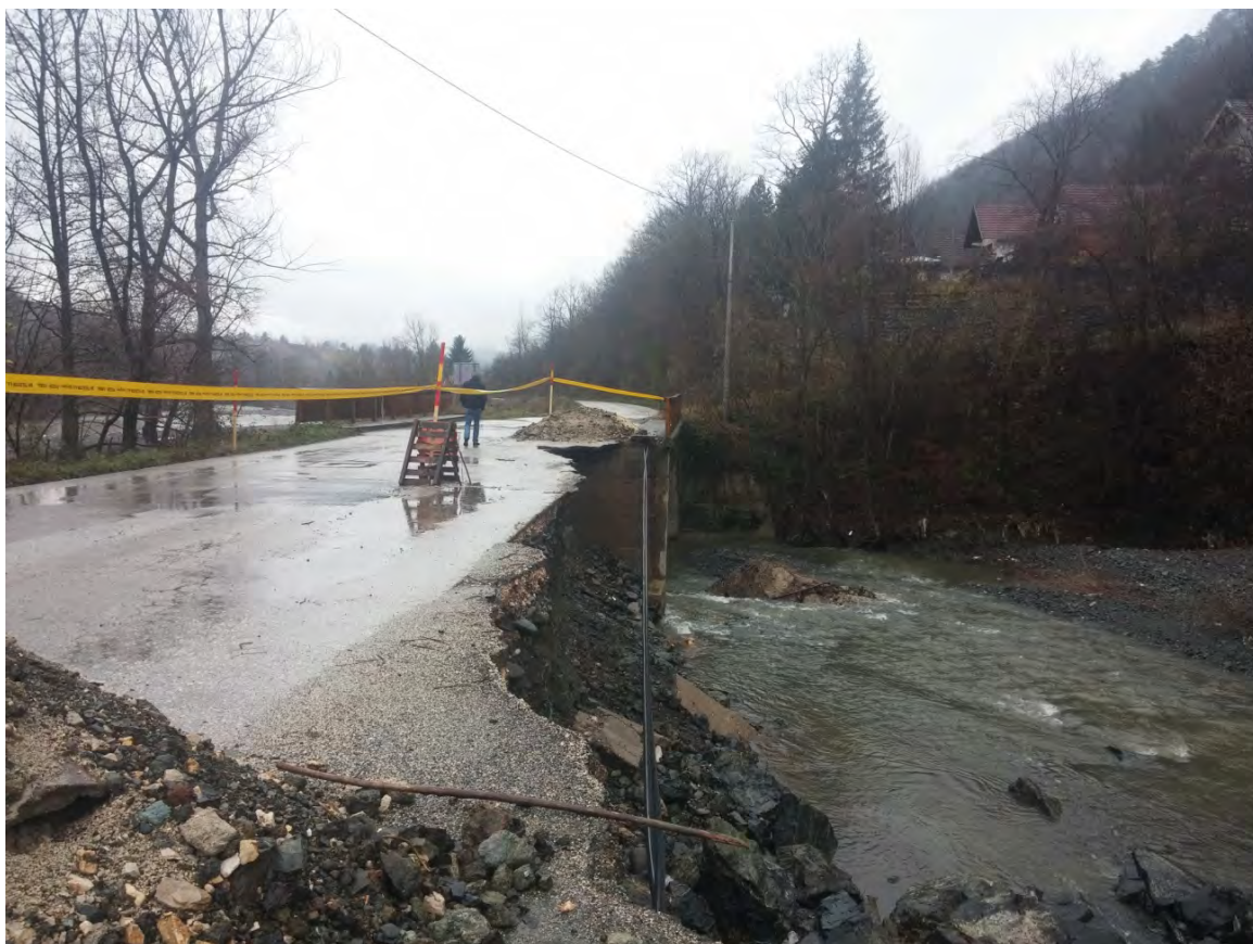
Slika broj: 49. Oštećenje ceste i krila mosta u mjestu Ribnica
