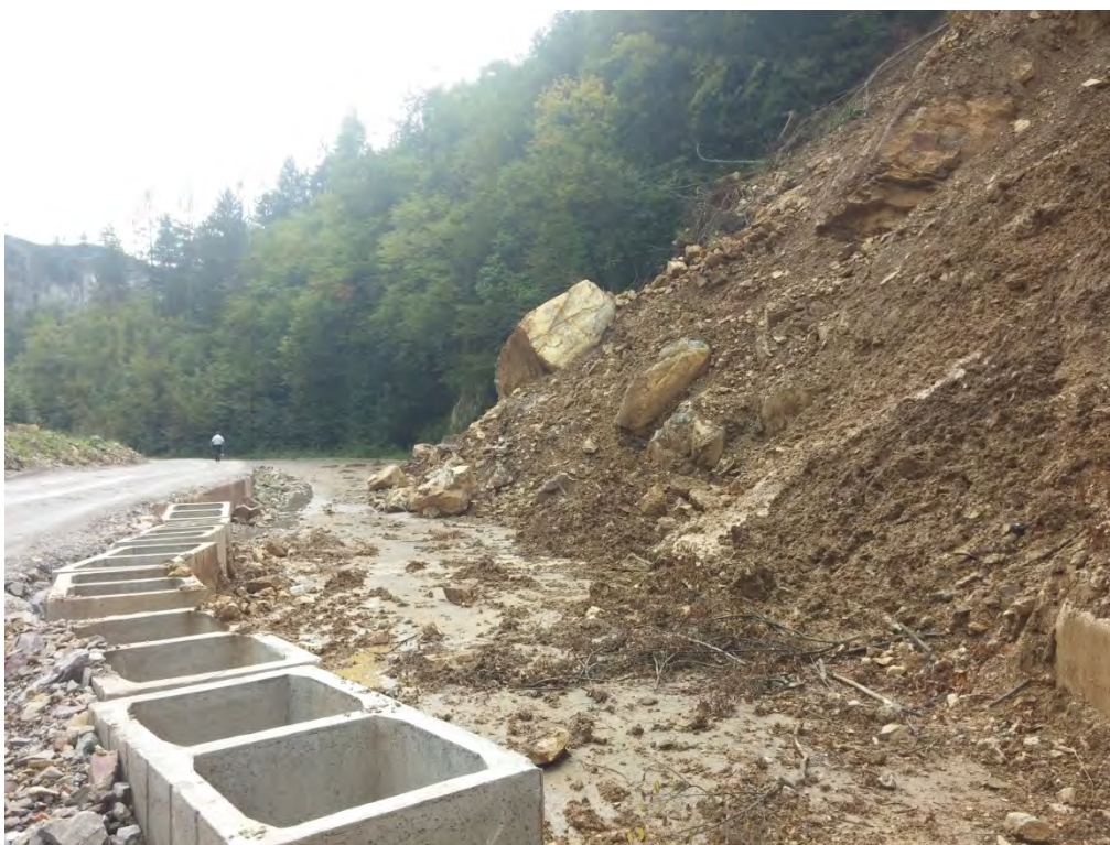
Slika broj: 16. Klizište „Kapija“
